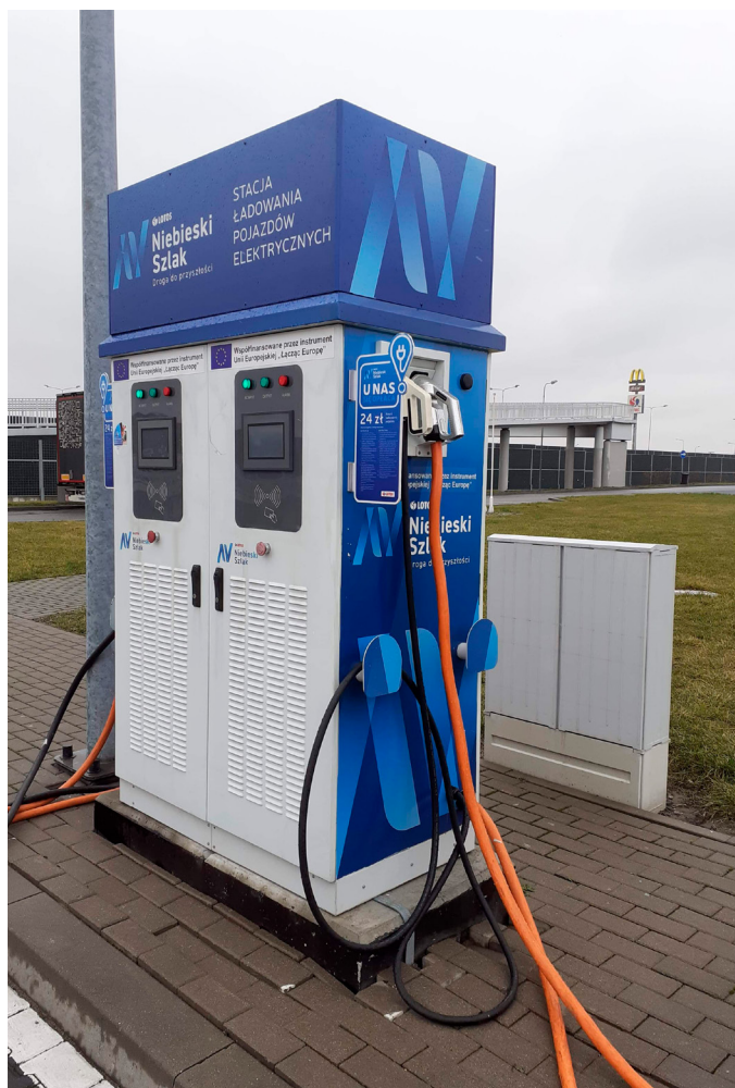
Stacja ładowania Brwinów Południe przy autostradzie A2
