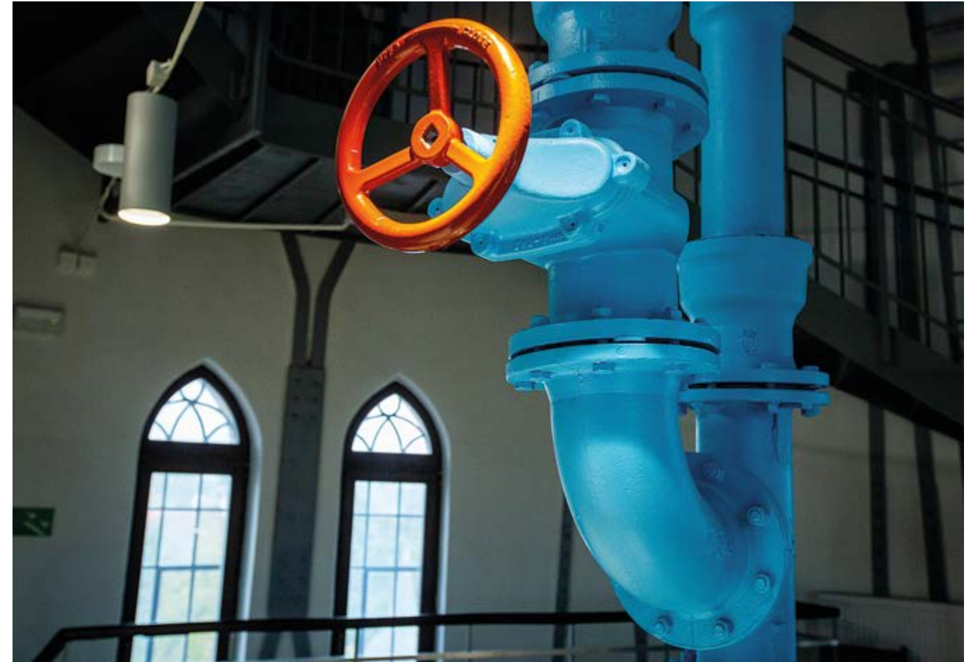
Malbork, wnętrze wieży ciśnieniowej, instalacja
